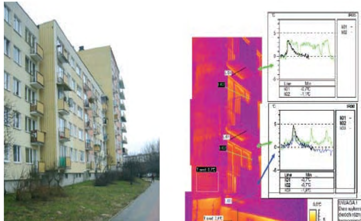
Rys. 15. Lokalne uciezki ciepła po ociepleniu elewacji w budynkach prefabrykowanych Źródło: Ostańska A., Stan techniczny i analiza energetyczna jako podstawowe aspekty rewitalizacji osiedli z budynkami wielkopłytowymi, Przegląd Budowlany, 2009
