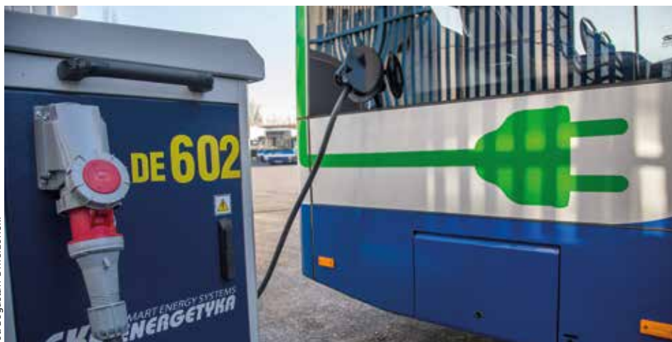
Ładowanie akumulatorów w zajezdni Wola Duchacka
