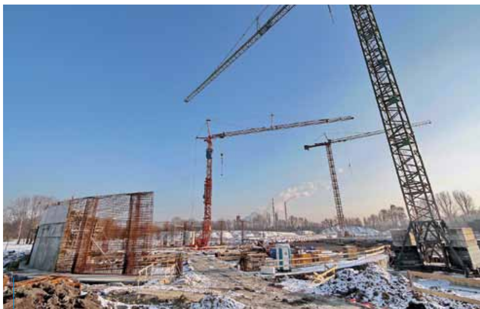
Prace przy inwestycji idą pełną parą – do końca roku powinien być gotowy stan surowy hali
