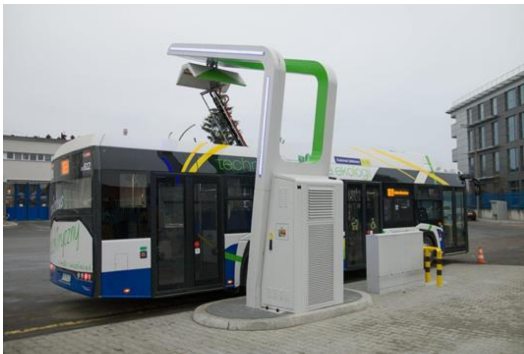
Rozwój elektromobilności. Stanowisko ładowania pantografowego autobusów elektrycznych [fot. MPK SA w Krakowie]
