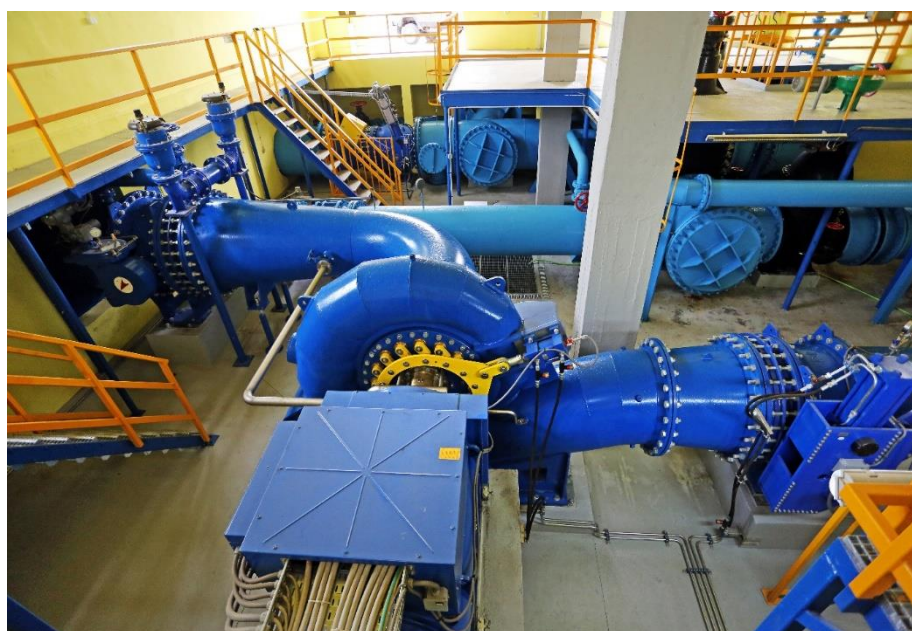
Działania spółek komunalnych. Turbina wodna na tranzycie wody pitnej w MPWiK [fot. MPWiK SA w Krakowie]
