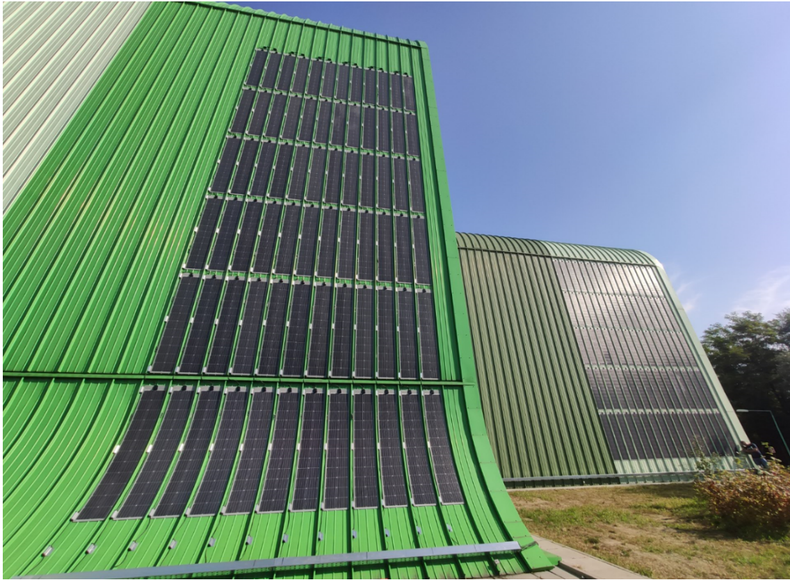
Innowacyjne działania: Elastyczne moduły fotowoltaiczne zamontowane na zakrzywionych ścianach Zakładu Termicznego Przetwarzania Odpadów (ZTPO)
