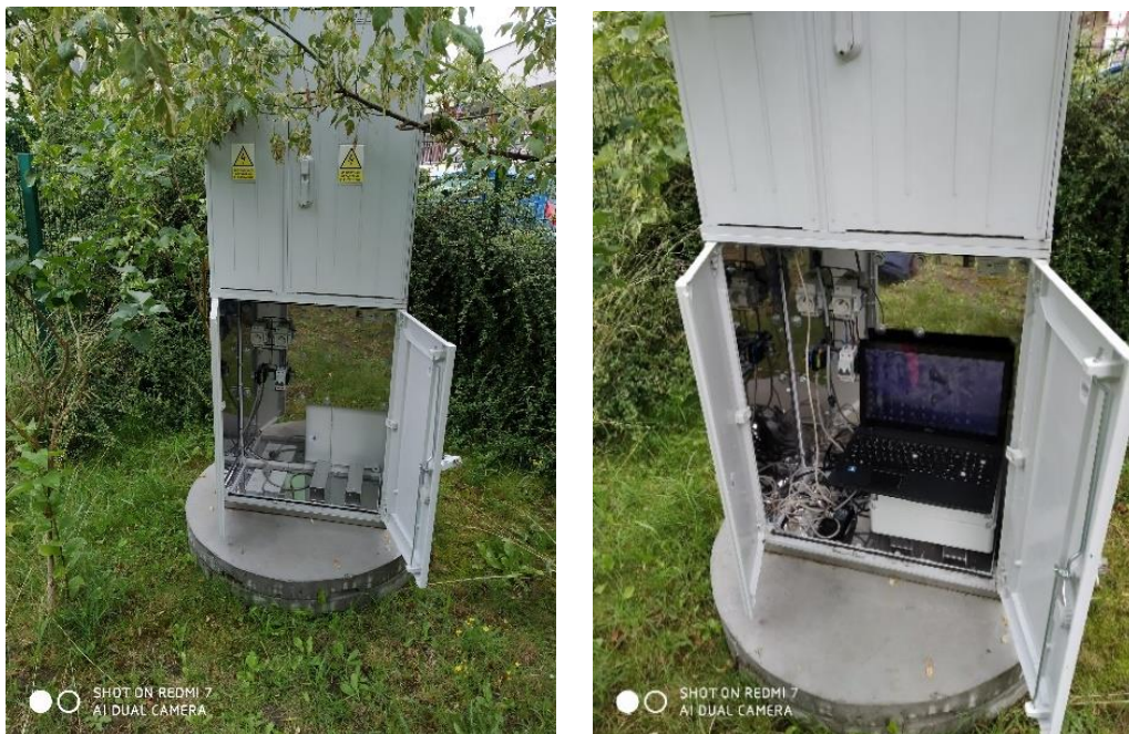
Rysunek 1. Stacja Bazowa AMS8061 na terenie Samorządowego Przedszkola nr 150
