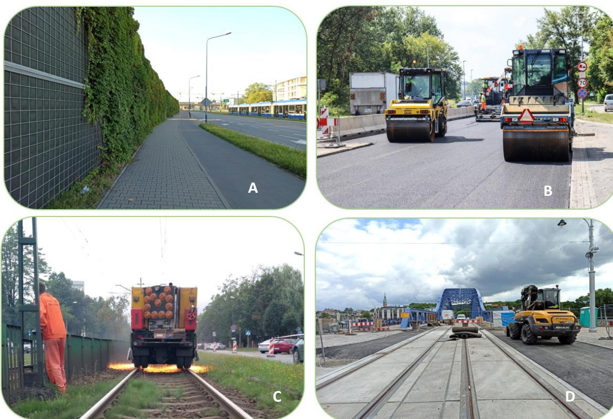
Rys. 6 Przykłady zastosowanych środków redukcji hałasu
