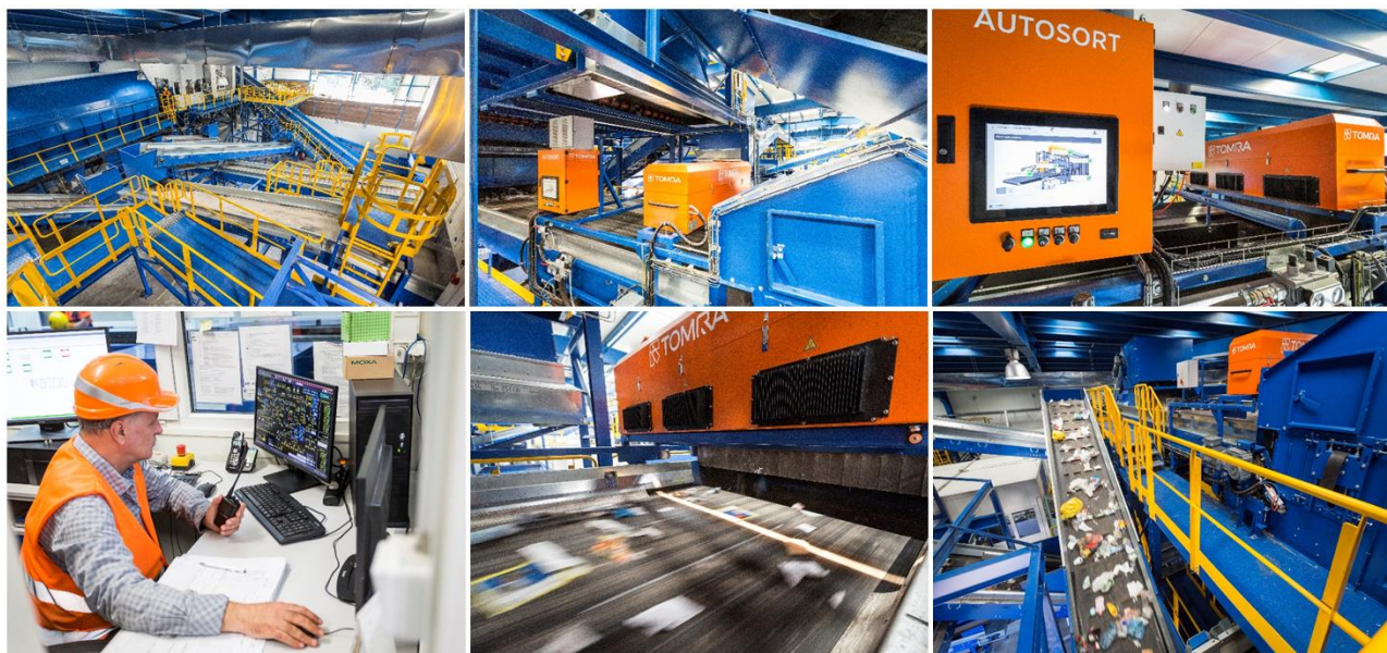
Rysunek 3A. 5. Zautomatyzowana sortownia odpadów selektywnie zbieranych.
