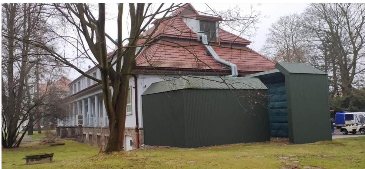
Ekran akustyczny systemu chłodzenia
