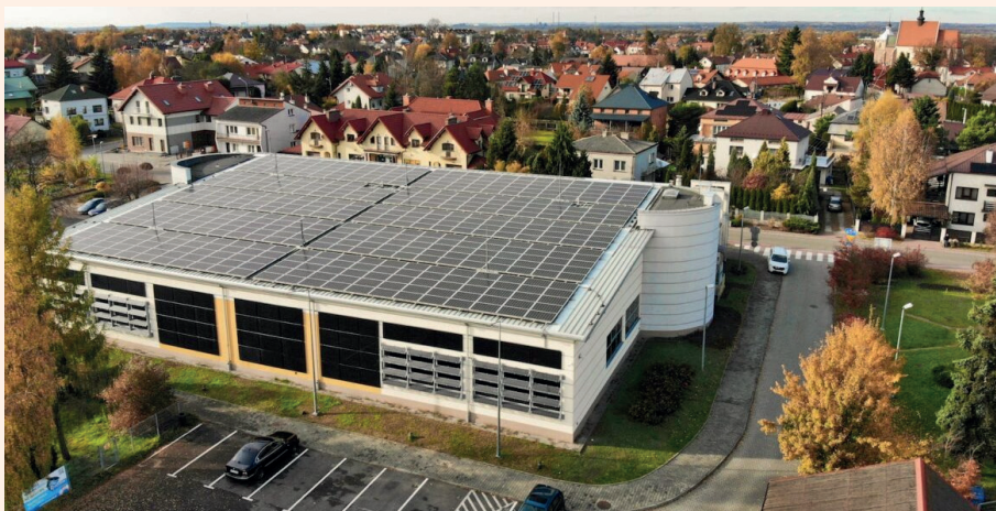
Zdjęcie 8: Instalacja fotowoltaiczna na krytej pływalni w Niepołomicach, zarządzanej przez spółkę Infrastruktura Niepołomice sp. z o.o. 24
