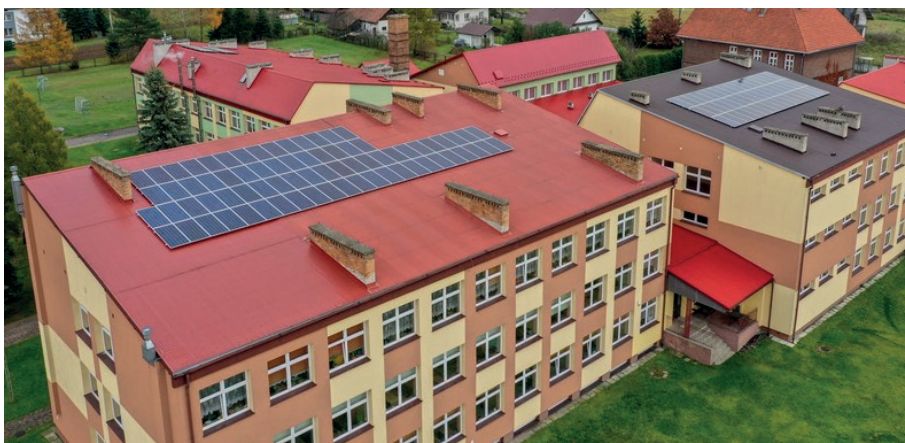
Zdjęcie 4: Panele fotowoltaiczne na dachu Szkoły Podstawowej w Odrzykoniu 19
