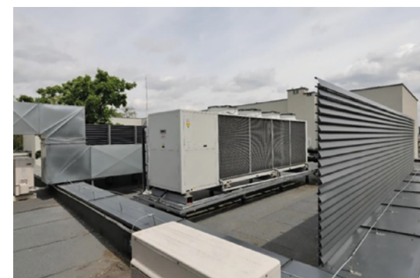
Rysunek 09-3 Powietrzna pompa ciepła na dachu płaskim budynku wielorodzinnego. Źródło: opracowanie własne.
